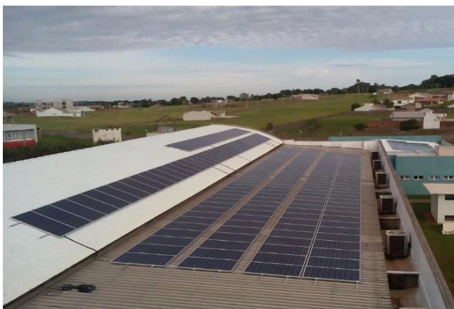
Figura 1 - Foto mostrando módulos instalados no bloco de salas de aula e ao fundo o bloco de laboratórios
